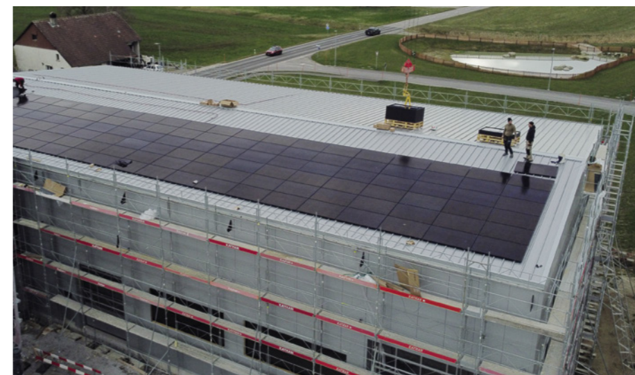
Projet sur notre halle de stockage de 158 kWc.
