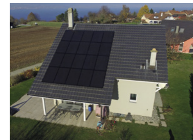
34 m 2 – 6 kWc 1474 Châbles
