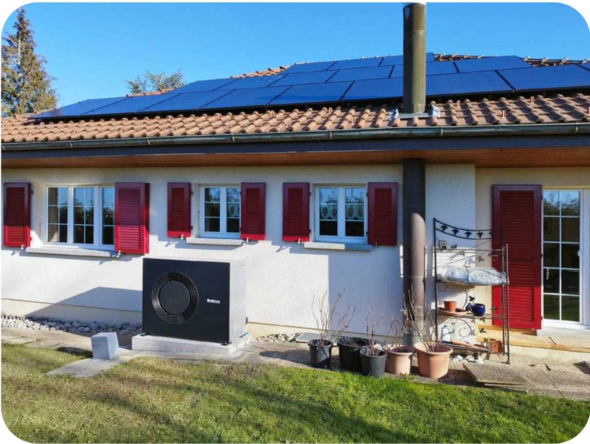
Buderus air/eau WLV186i avec centrale solaire
