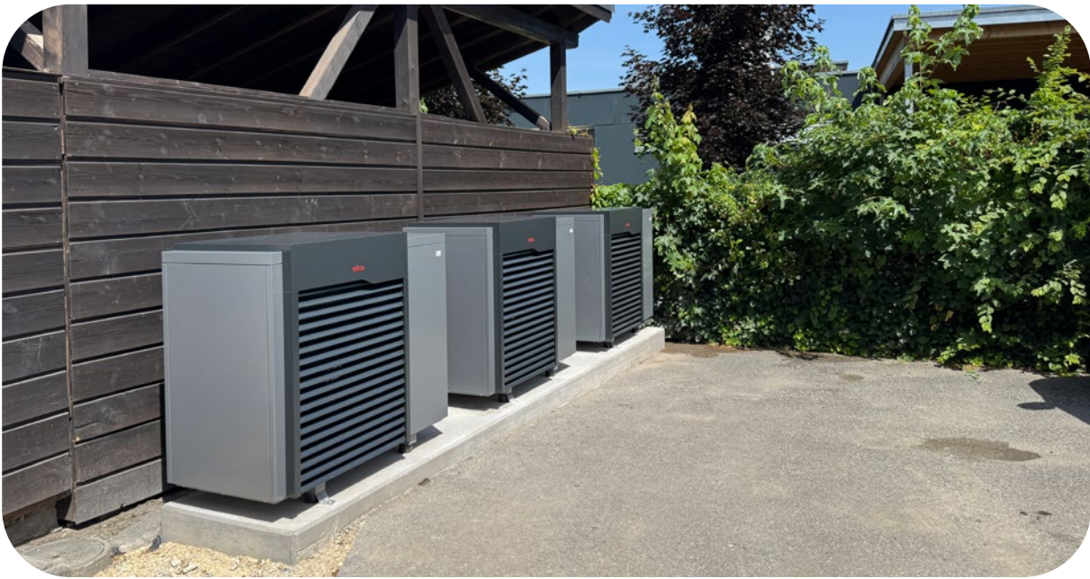
Elcotherm air/eau extérieur Aerotop SX (3 PAC en cascade)
